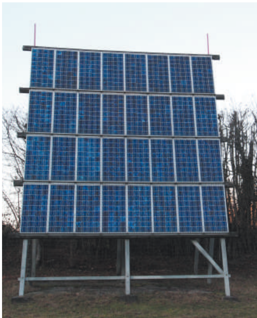
En 1999, les Didier installent des panneaux photovoltaïques dans leur jardin. Ils assurent encore l'essentiel de leur consommation électrique.
